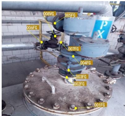
图档编码: XYLGQ0-01-01-0036 泄漏修复点: 004FG 装置: 原料罐区 区域: 原料罐区 设备/管线工艺名称: PX收集槽 设备/管线工艺编号: P3101003
