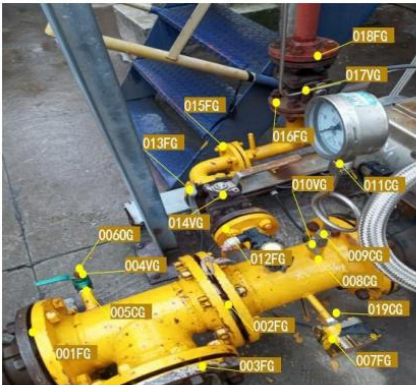
图档编码: XFSZZ0-01-01-0040 泄漏修复点: 002FG 装置: 焚烧装置 区域: 焚烧装置 设备/管线工艺名称: 蒸汽锅炉 设备/管线工艺编号: /
