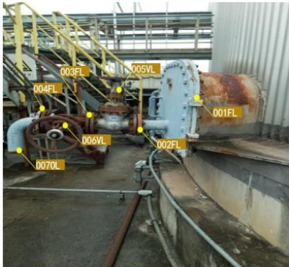
图档编码: XHCGQ0-01-01-0046 泄漏修复点: 001FL 装置: 缓冲罐区 区域: 缓冲罐区 设备/管线工艺名称: 对二甲苯储罐 设备/管线工艺编号: B
