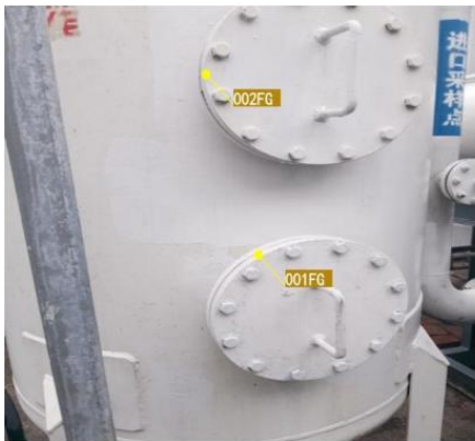
图档编码: XYLGGQ0-01-01-0067 泄漏修复点: 001FG 装置: 原料罐区 区域: 原料罐区 设备/管线工艺名称: 油气处理设施 设备/管线工艺编号: E0101
