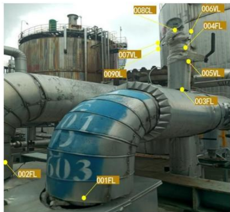
图档编码: XZJGQ0-01-01-0058 泄漏修复点: 003FL 装置: 中间罐区 区域: 中间罐区 设备/管线工艺名称: PX输送泵 设备/管线工艺编号: G2603A
