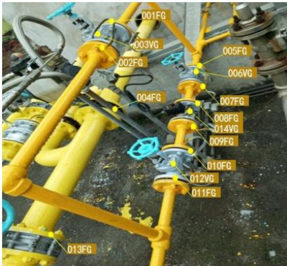
图档编码: XFSZZ0-01-01-0074 泄漏修复点: 009FG 装置: 焚烧装置 区域: 焚烧装置 设备/管线工艺名称: 燃气至火炬管线 设备/管线工艺编号: /
